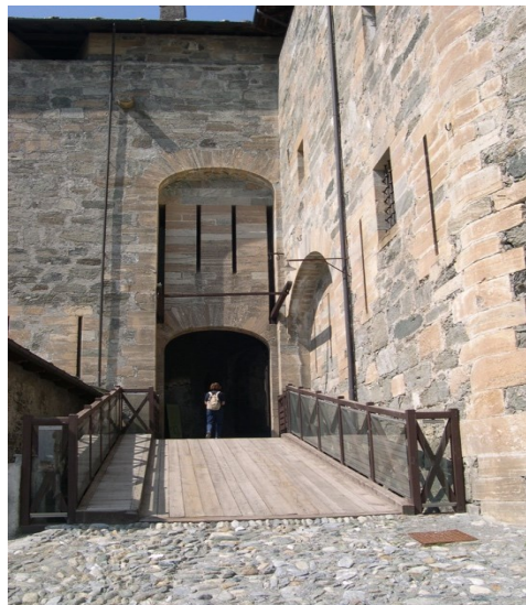
Fig. 2- Forte di Exilles, ingresso al cortile del “Cavaliere”, prima dell’intervento di restauro (2005)
