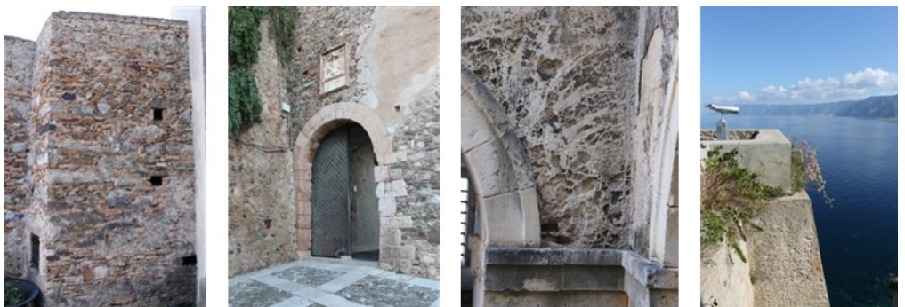
Fig. 10- Materiali costitutivi e degradi
