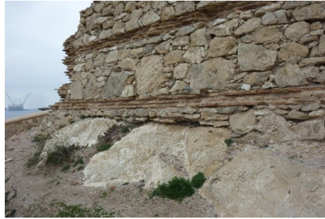
Fig. 5- Detalle del apoyo del muro ataludado en la roca de cimentación. (P.E. Collado)
