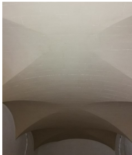
Figs. 10-11- Bóvedas y vista parcial del almacén tras instalación del módulo de recreación visual (autor: J. A. Mira Rico)
