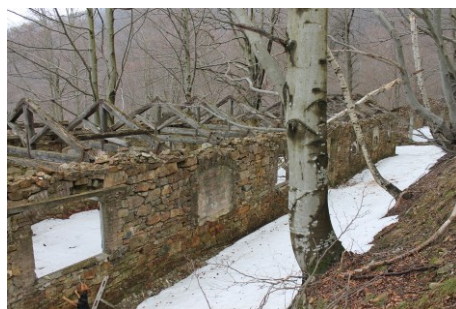
Fig. 13- Vista di una delle casermette del Melogno, in totale abbandono e degrado.
