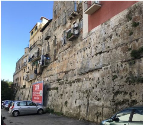
Fig. 9- Tratto di mura nell'odierna Via Rocca Portalegni, foto dell'autore. Su questo ampio fronte murario nelle immediate vicinanze del corso del torrente Portalegni, oggi via Tommaso Cannizzaro
