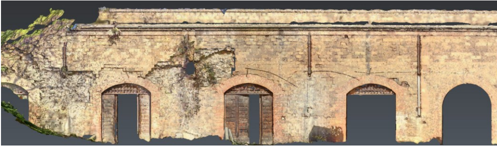
Fig. 6 – Il prospetto dei ricoveri, sui quali sono visibili i fenomeni di spaccamento in atto nella muratura. Ortofoto estratta dalla nuvola di punti
