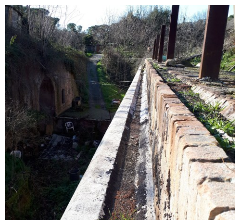
Fig. 3- Il canale di raccolta, delle acque, sul muretto del traversone e l'incavo nella cornice in travertino
