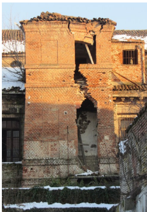
Fig. 1- Cittadella di Alessandria, le condizioni precarie di uno degli edifici (foto di Guido Ratti, 2017)
