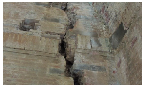
Fig. 10- I presidi in materiale lapideo utilizzati per ammorzare due paramenti interessati da una lesione, successivamente solleccitati e rotti da un nuovo movimento sismico
