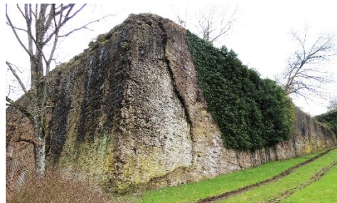
Fig. 7- Un esempio di foderatura esterna in laterizio di un paramento della Fortezza dove risulta ben visibile la scarsa ammorsatura con la muratura interna
